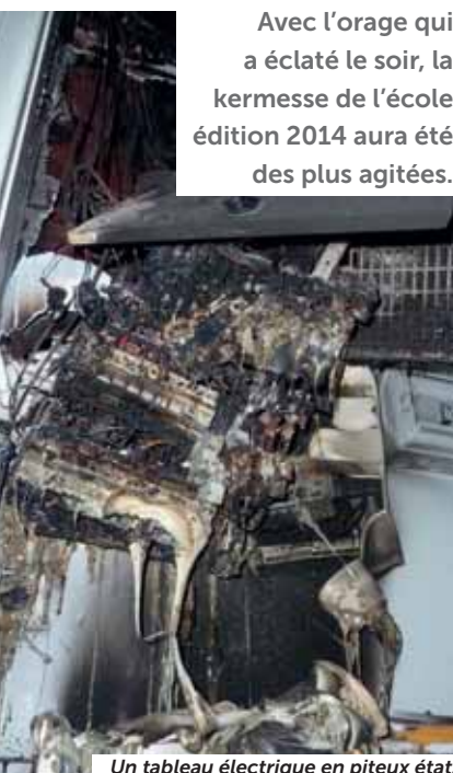
Un tableau électrique en piteux état.
